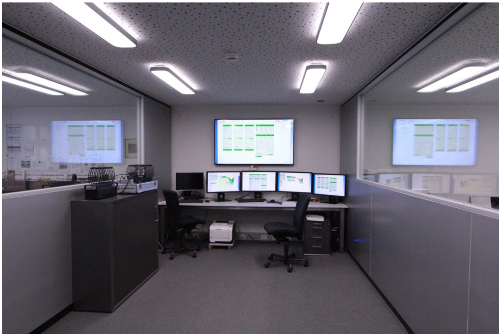
Einblicke in die Welt der Technik: Der Kommandoraum im Wasserkraftwerk Kubel, St. Gallen (Bildquelle: St.Gallisch-Appenzellische Kraftwerke AG (SAK))
